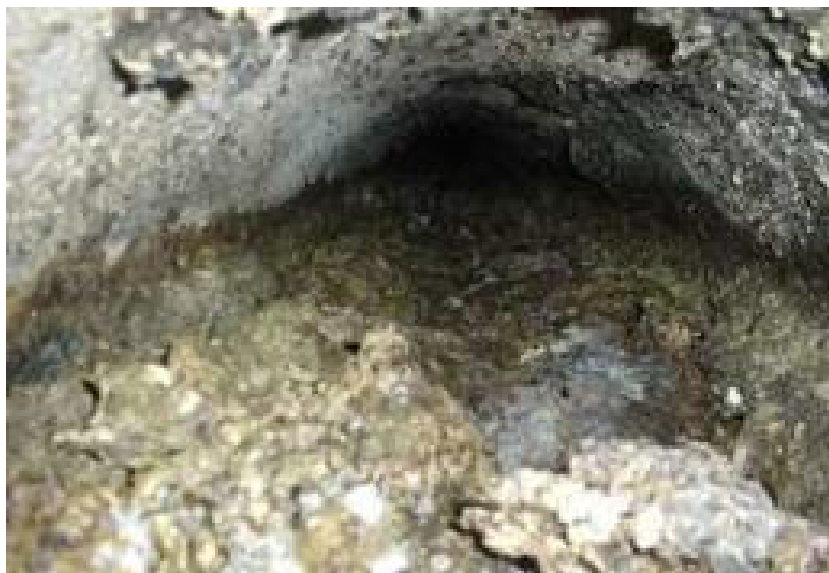
配管のつまり（油脂類）
