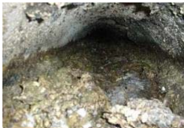
配管のつまり（油脂類）
