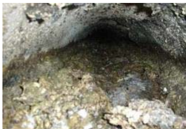
配管のつまり（油脂類）
