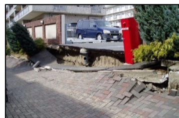
東日本大震災での被害
