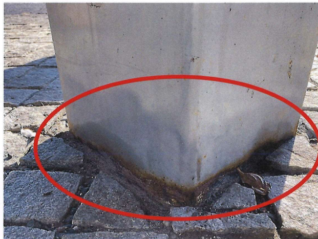
地際部の発錆腐食状況
