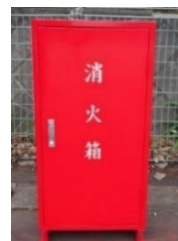
初期消火箱（固定式）
