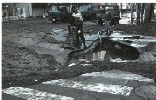
▲横浜市神奈川区鶴屋町での漏水
