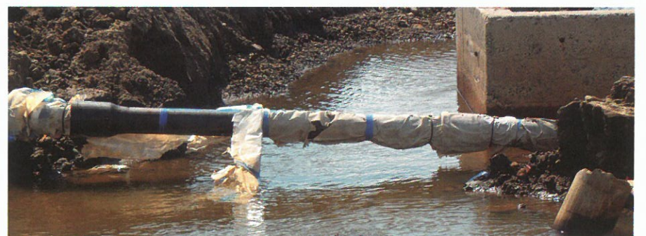
▲東日本大震災の津波にも耐えた耐震管(平成23年 仙台市水道局提供)
