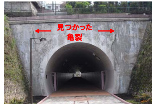
高島山トンネル反町側入口の亀裂
