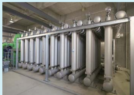
川井浄水場の膜処理装置 (セラロック)
