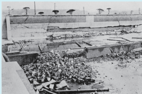
野毛山 1 号配水池の惨状
