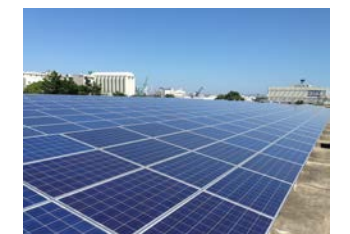
太陽光パネル (神奈川水再生センター)
