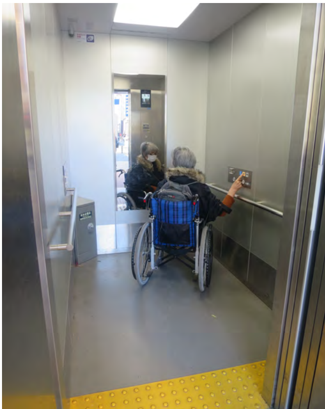
大型エレベーターを設置した例（新横浜駅：定員 20 人）
