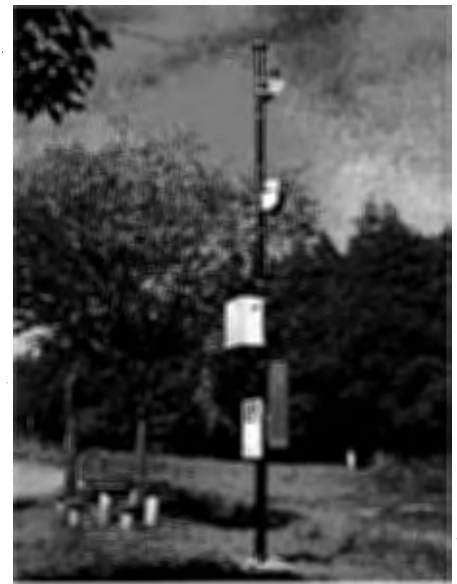
親水拠点警報装置 (和泉川 東山の水辺、瀬谷区)
