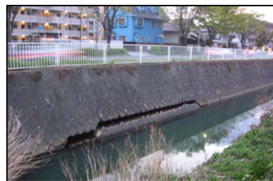
老朽化による河川の護岸崩落
